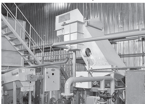
Очистные сооружения ливневых сточных вод Экспериментального предприятия
